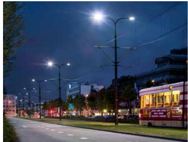
Gemeente Rijswijk samen met CityTec: 40% energiebesparing door ledverlichting boven de tram.
